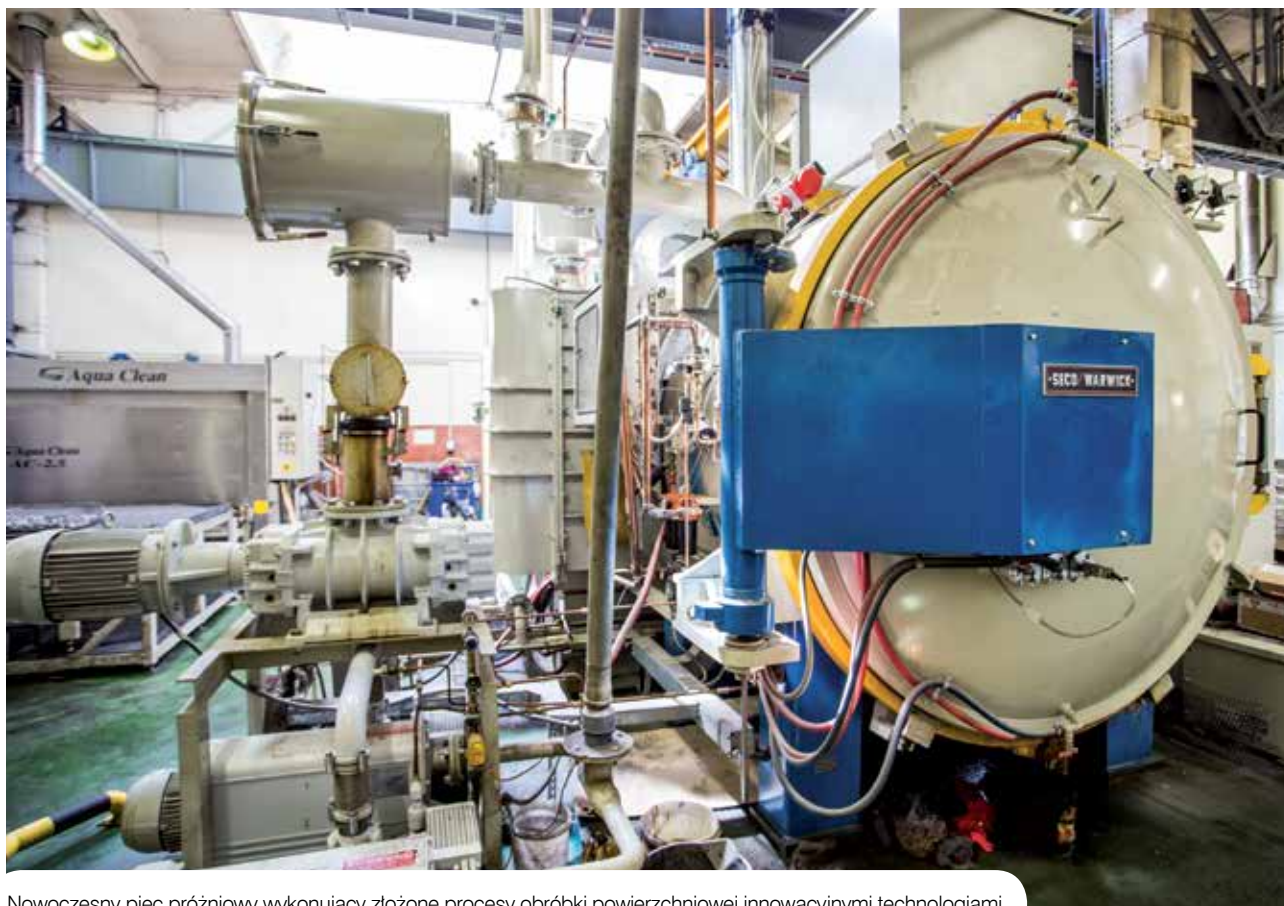
Nowoczesny piec próżniowy wykonujący złożone procesy obróbki powierzchniowej innowacyjnymi technologiami
