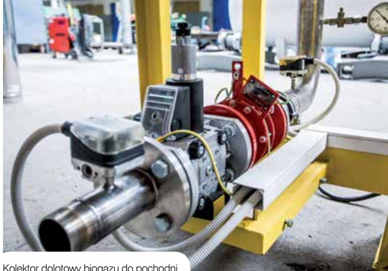
Kolektor dolotowy biogazu do pochodni
